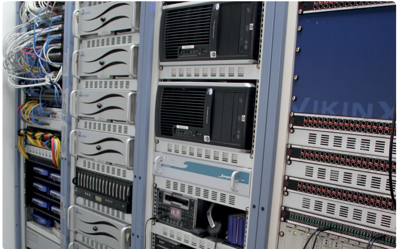
Zona de servidores donde están los racks que contienen los sistemas VSN
