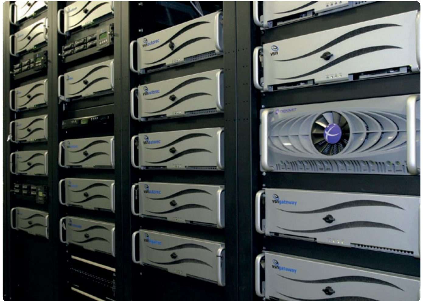
Cuatro racks VSN de almacenamiento y sistema en red completamente redundante
